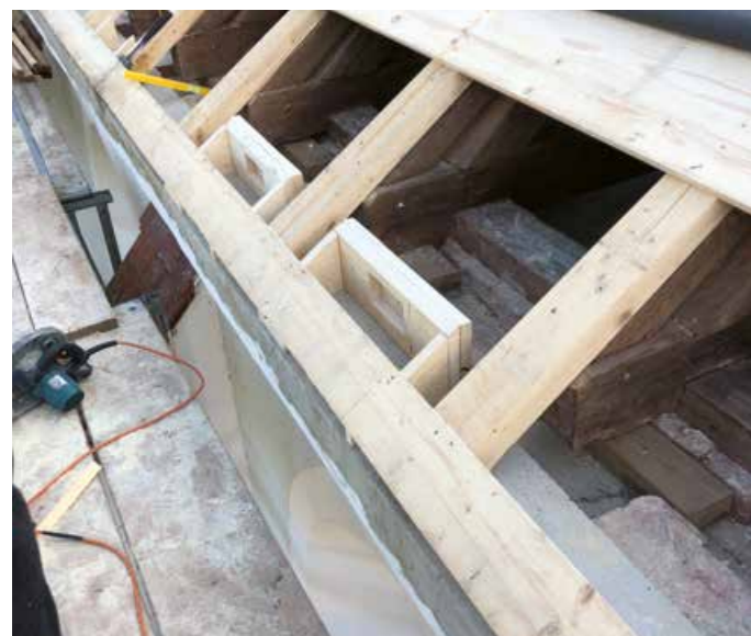
▲ Ein Heim für Mauersegler: Die Handwerker mussten die alten Nistplätze erhalten und schützen
