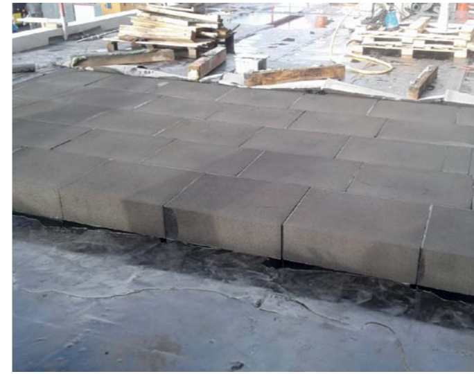
▲ Sowohl die Dämmung des Flachdachs als auch der Besucherterrassen wurden mit Schaumglasplatten ausgeführt
