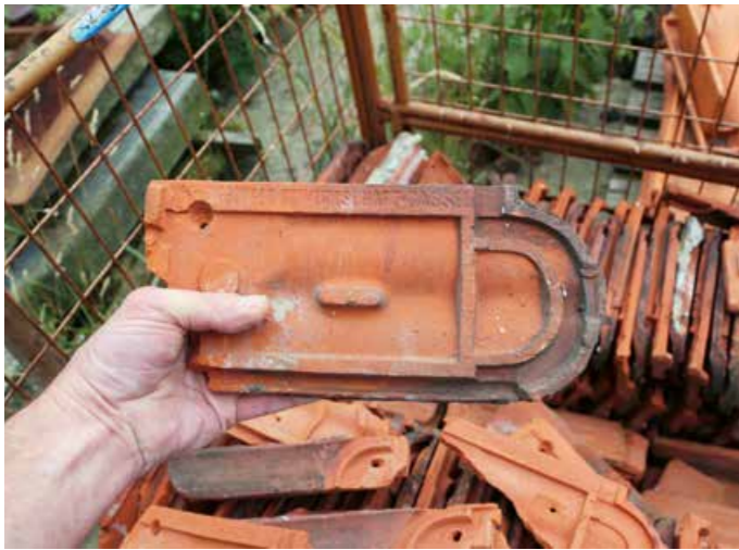
▲ Viele der Turmfalzziegel des kleinen Glockenturms waren beschädigt
