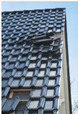
▲ Typischer Sturmschaden am Ortsgang eines Satteldachs
