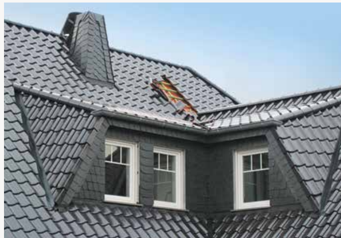
▲ Sturmschaden oberhalb von First und Gaube: Wer hier nur nach Gefühl verklammert, wird womöglich in die Haftung genommen
