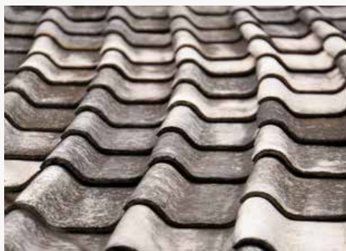
▲ Krumm: Die Dachsteine folgen der schlechten Lattung
