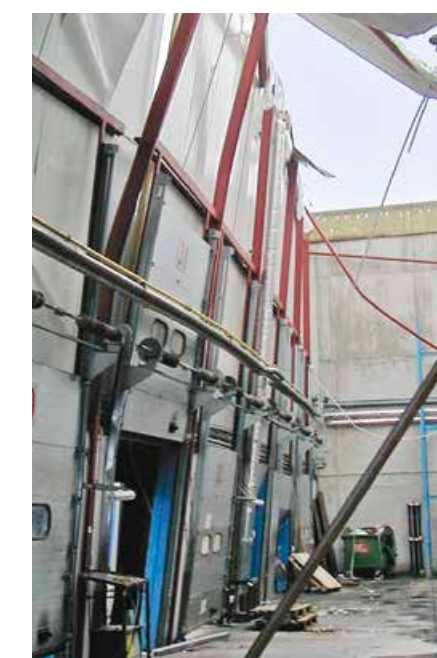
▲ Unwetter mit Folgen: Wasseranstau durch Starkregen brachte dieses Flachdach einer Lagerhalle zum Einsturz
