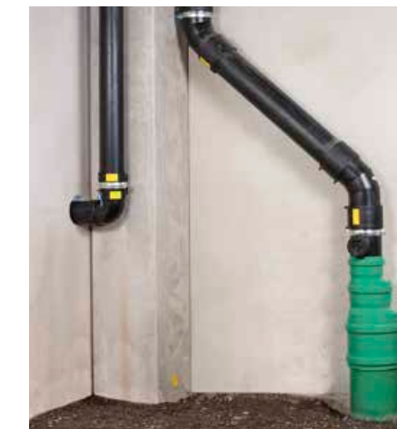
▲ Die Leitungen für Haupt- (rechts) und Notentwässerung müssen getrennt sein
