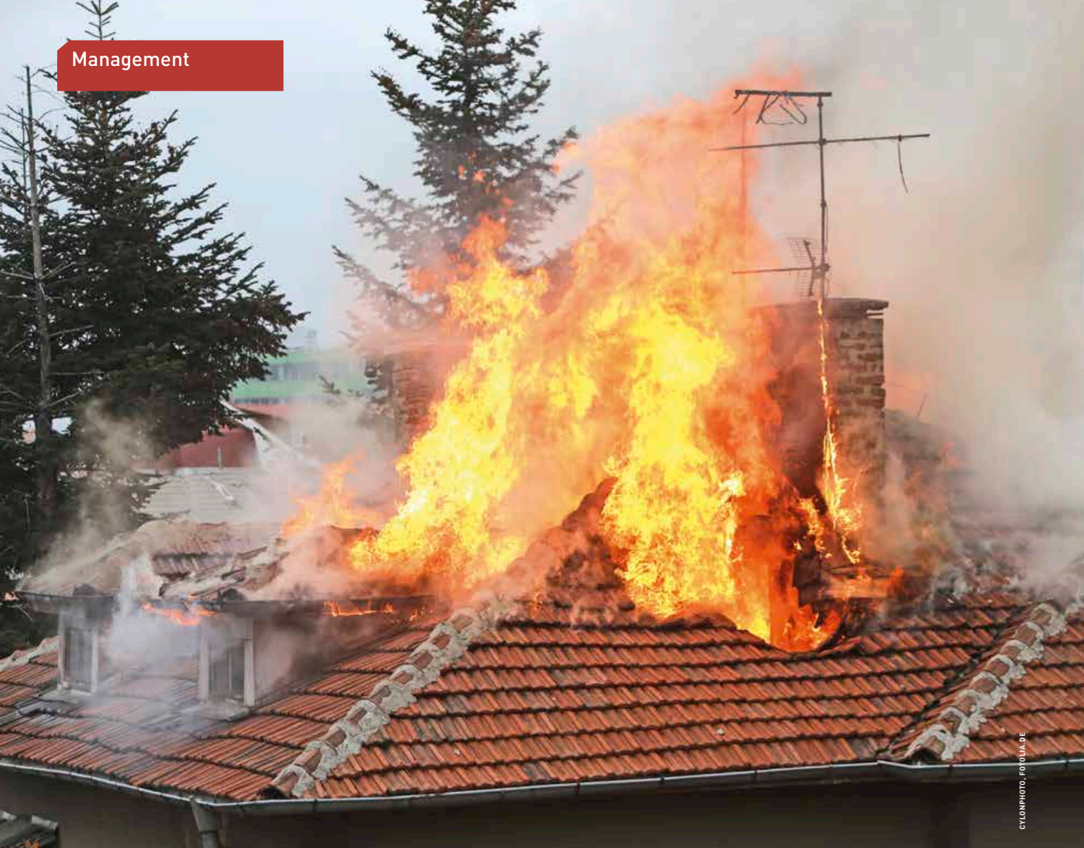
▲ Ein Fall für die Haftpflichtversicherung: Hier hat der Dachaufbau vielleicht durch fahrlässige Lötarbeiten oder eine ausgerauchte Zigarette Feuer gefangen
