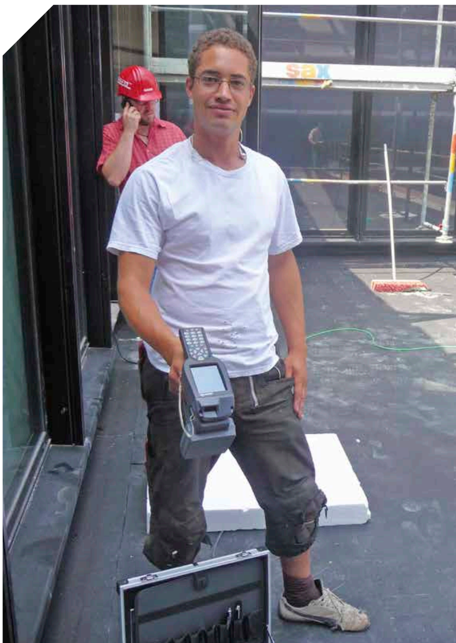
▲ Im Flachdach alles okay? Über das Handlesegerät lassen sich die in der Dämmschicht eingebauten Sensoren jederzeit ansprechen, sodass Klarheit über den Zustand der Abdichtung herrscht
