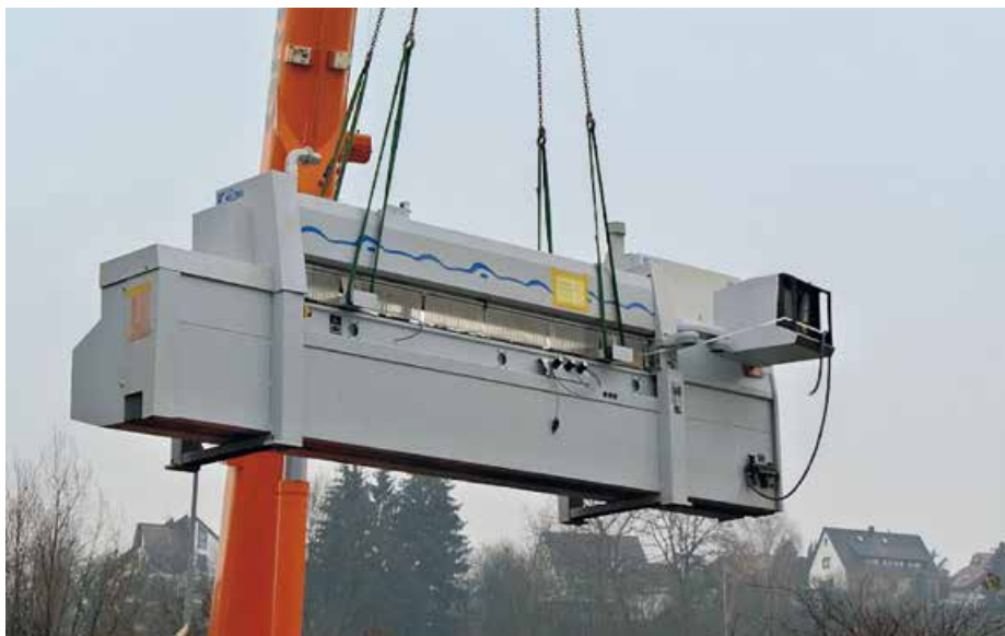
▲ Schwere Last: Große Maschinen lassen sich am einfachsten durchs Dach austauschen
