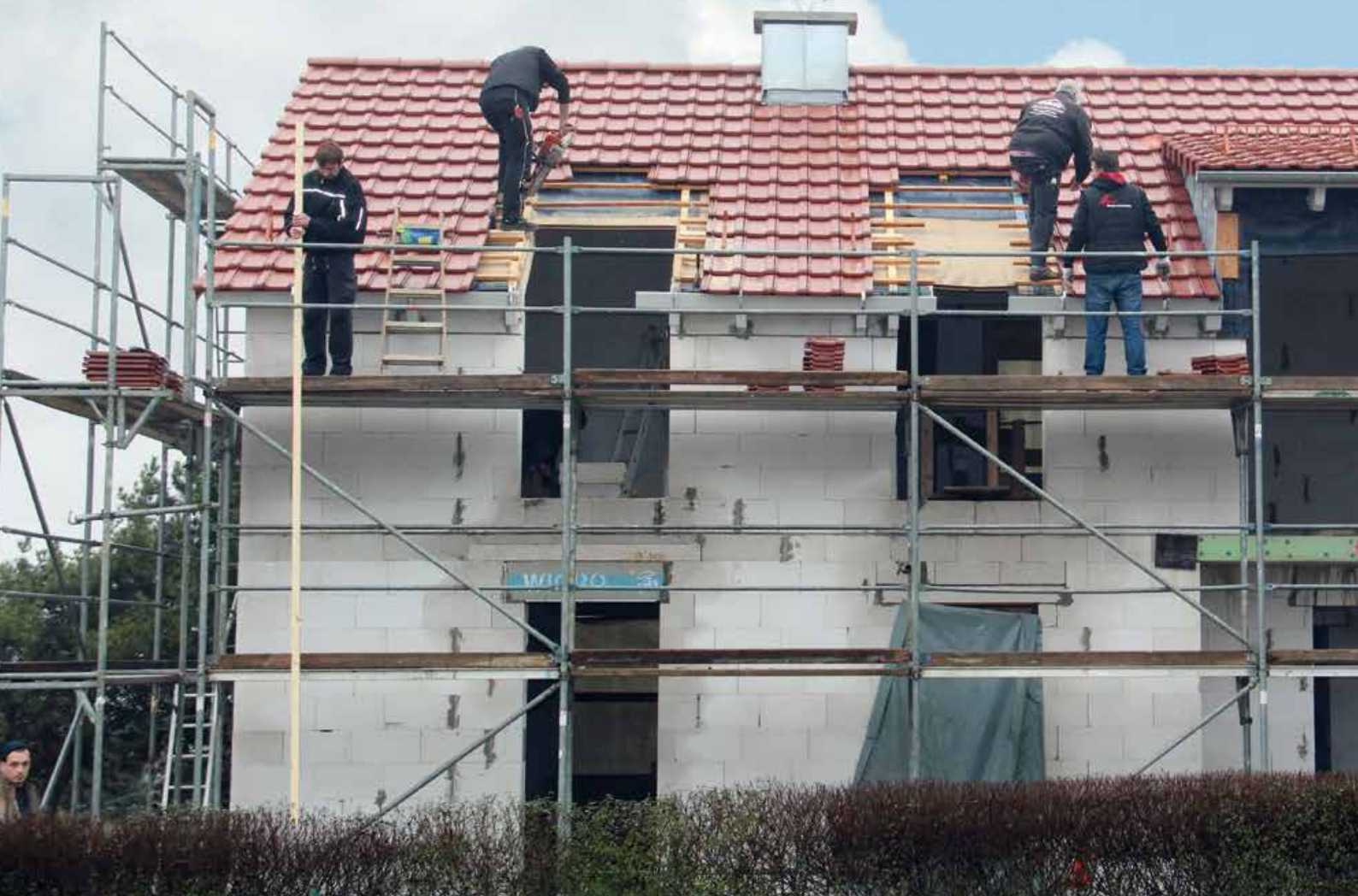
▲ Premiere: Im Dach eines Neubaus in der Fränkischen Schweiz kam ein neu entwickeltes Dachfenster von Roto erstmals auf der Baustelle zum Einsatz
