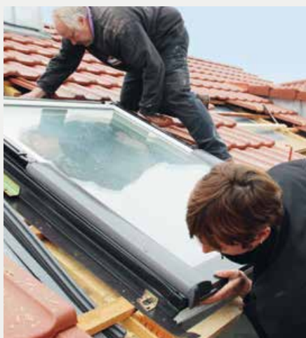
▲ Danach kann das neue Dachfenster RotoComfort i8 vorsichtig in die Dachöffnung gehoben und positioniert werden
