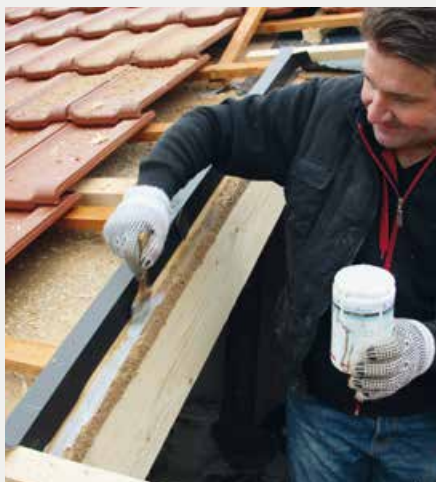
▲ Danach folgen weitere Vorbereitungen für den folgenden Dachfenstereinbau: Durch das Primern und ...
