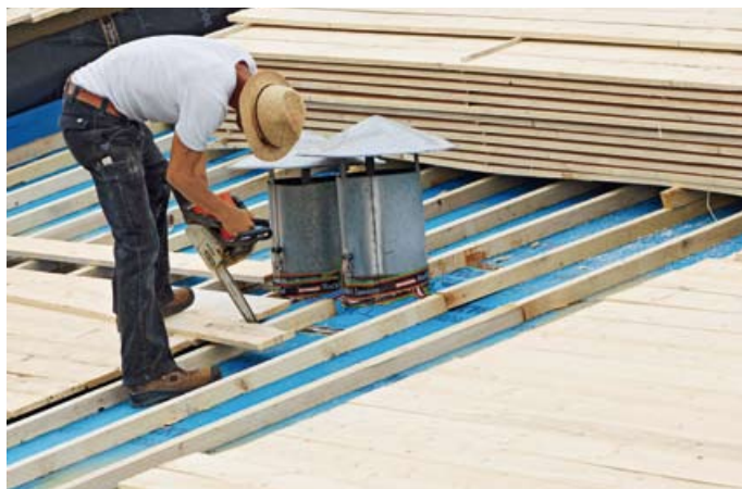
▲ Auf der Grundlattung verlegte das Dachdeckerteam eine 24 mm dicke Holzschalung und eine strukturierte Trennlage
